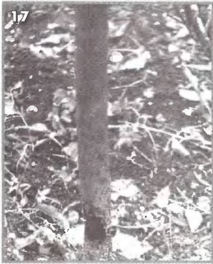
Фото 17. Наиболее интенсивно разрушается та часть столба, которая расположена на стыке с поверхностью земли
